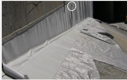
Vue d'un piédroit du divergent terminé avec événements et plats inox fixés par des vis
