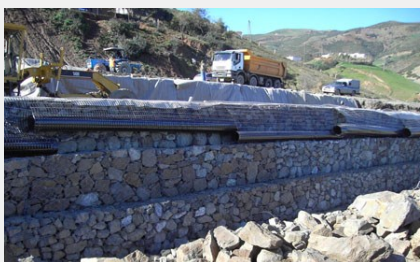
Nappes Enkagrid ® en attente pendant le nivellement et le compactage du remblai
