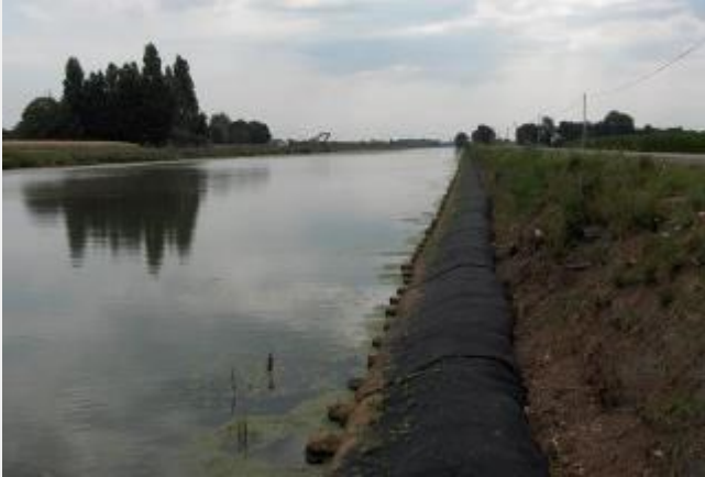
Vue d'une risberme en pieds de berge formée par l'Enkammat A20 avant plantation
