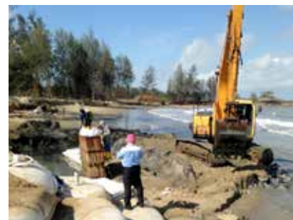
Enka-G-Bag wordt gevuld met het ter plaatse aanwezige zand, zodat geen transport van stenen of opvulmateriaal nodig is.
